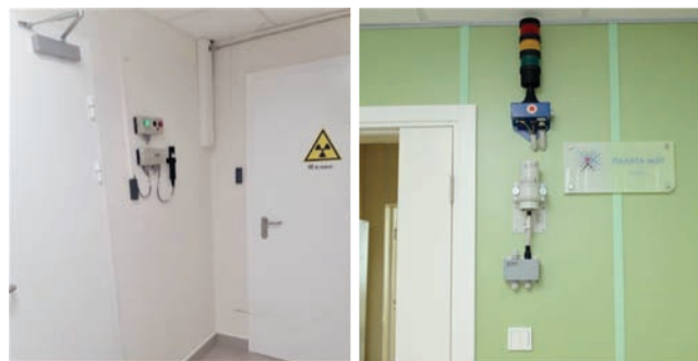
Рис. 1. АСРК MediSmarts Radiation Monitoring System (слева); АСРК УДКС-01 «Пеликан» (справа)
