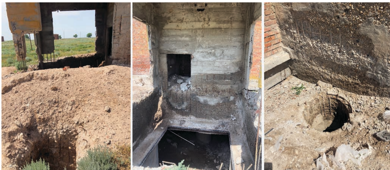
Рис. 5. Неликвидированные колодцы и провалы Fig. 5. Unliquidated wells and sink-holes
